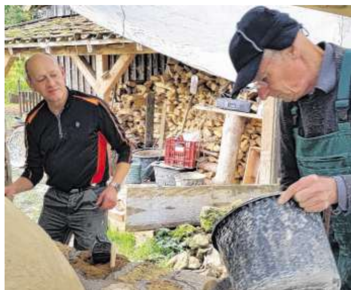
Schlusspunkt: Rainer Wittig (links) und Wolfhart Kansteiner setzen die letzten Steine für die Außenmauer des Ofens an der Ravensburg und verstreichen die letzten Fugen.
