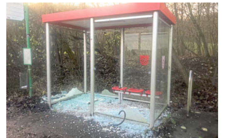
Sechs Bushaltestellen wurden in Borgholzhausen und Werther, neun weitere in Melle zerstört.
