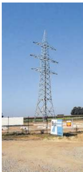
Aufwendig: Wo die Leitung vom Himmel in die Erde geht, muss eine komplizierte Übergangsstation gebaut werden. FOTO: HK
